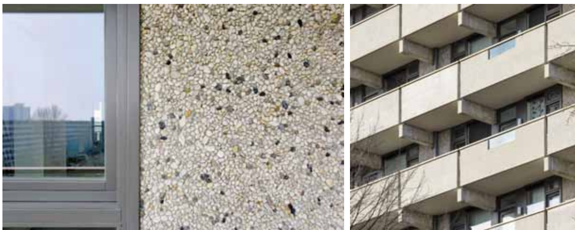
Иллюстрация 8. Project De Flat , Vijlmermeer. Амстердам, Голландия. 2016 г. Автор: NL Architects и XVW architectuur. Источник: https://www.archdaily.com/ . Фото Marcel van der Brug. Фрагменты фасада здания
